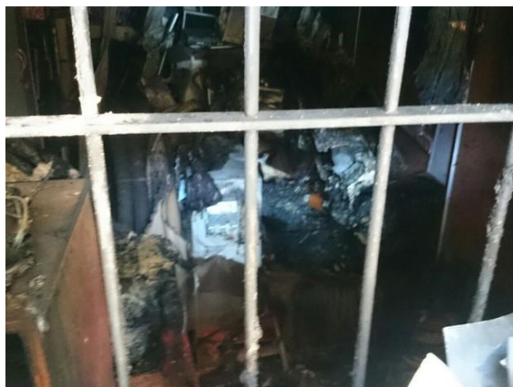
Figura 11 Incêndio no Hospital Universitário da Universidade Federal de Santa Catarina, em 2016 Fonte: G1 (2016)
