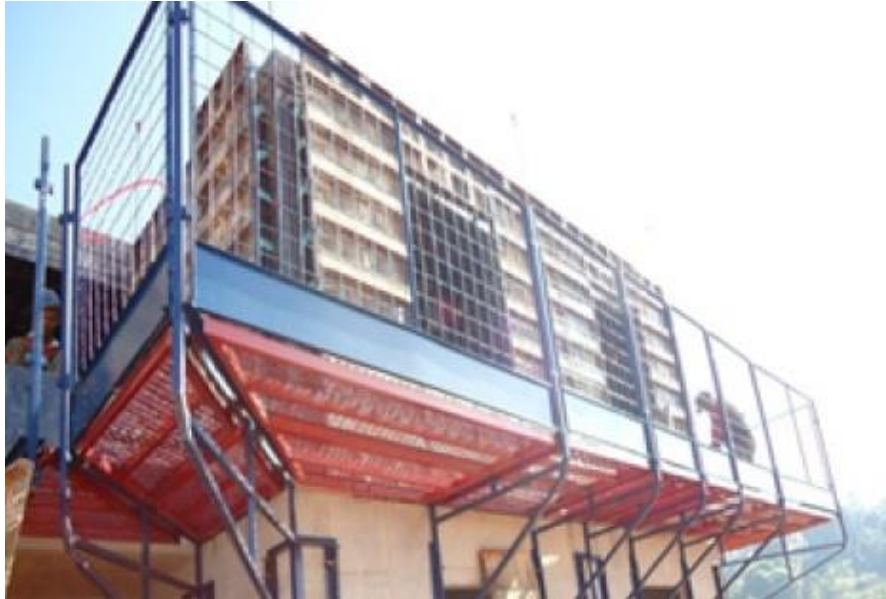
Figura 3 Guarda-corpo em andaime de balanço
