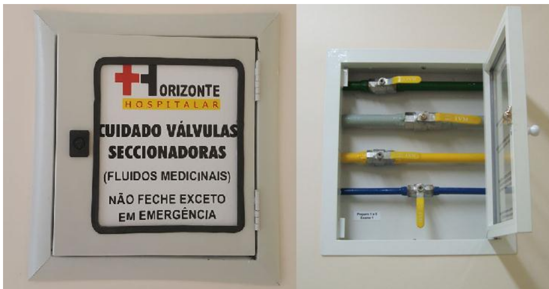
Figura 6. Exemplo de válvulas seccionadoras de gases medicinais Fonte: HORIZONTE HOSPITALAR (2017).
